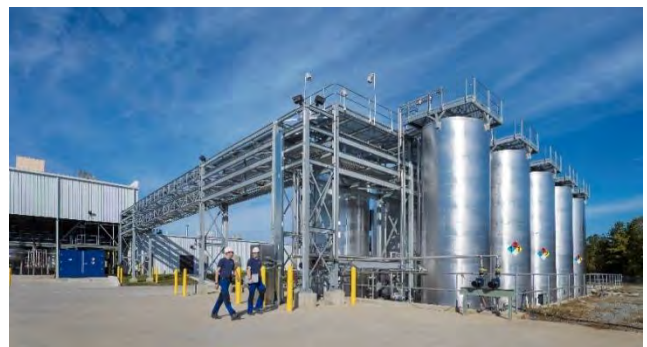
Abb.1: Zu den Abnehmern der Tanklager, Mischstationen, Reaktions- und Versorgungsanlagen zählen international tätige Konzerne
